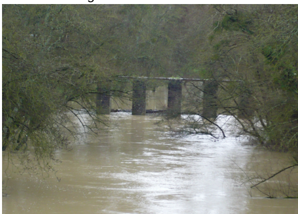
Ouvrage "anti-retour" sur la Cisse
